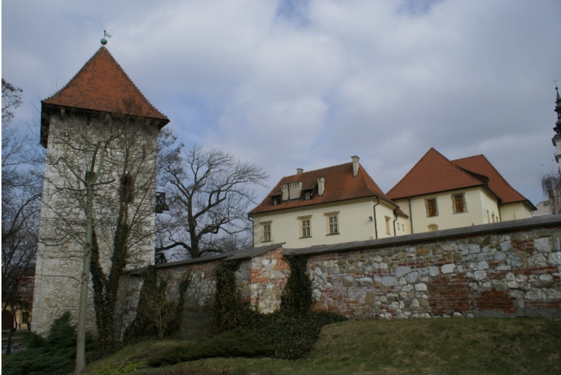
2) Muzeum Żup Krakowskich Wieliczka, na sfinansowanie remontu elewacji muru wschodniego w kompleksie Zamku Żupnego w Wieliczce; kwota 55 000 zł
